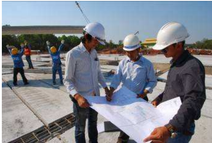
รูปที่ 13 แสดงการตรวจ Shop drawing ก่อนทำการติดตั้ง
