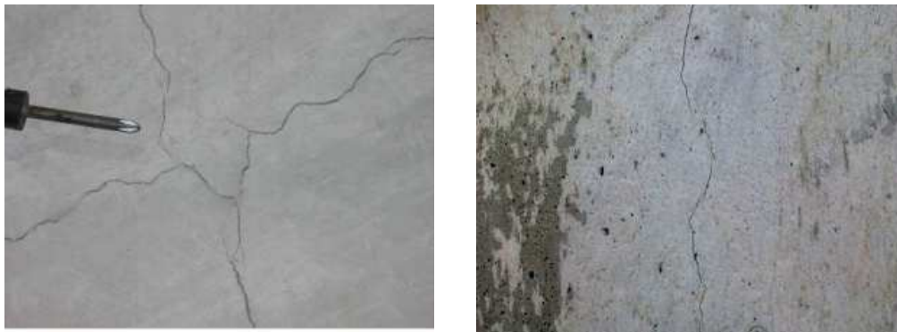
รูปที่ 30 แสดงการเกิด Drying Shrinkage บนแผ่นพื้น HollowCore
